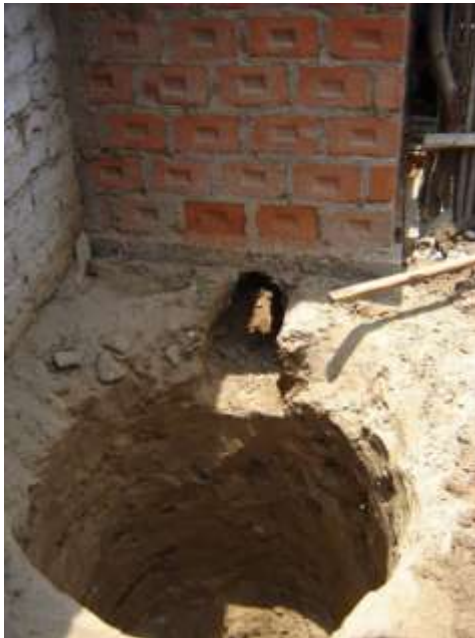
Biodigestor de 600 l.
